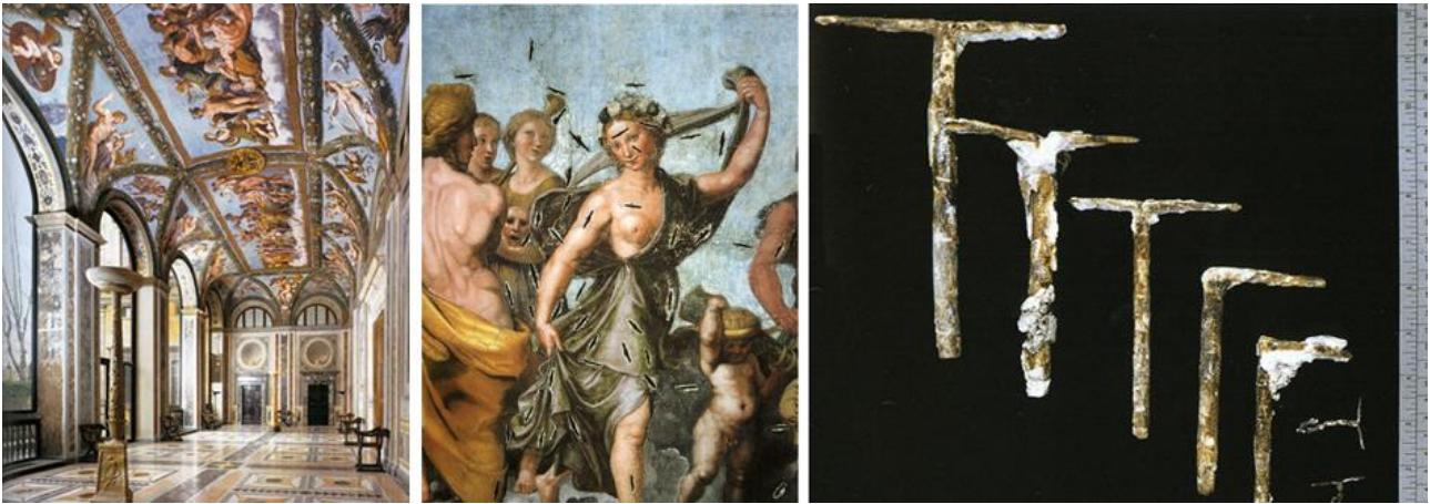
Fig. 2 FARNESINA, loggia di Amore e Psiche: i recenti restauri condotti dall'ICR hanno assicurato la stabilità e il controllo delle lesioni lasciando in opera le 850 grappe metalliche inserite da Maratta alla fine del XVII secolo.
